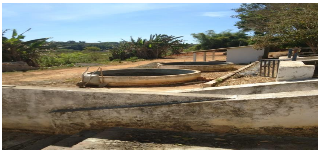
Figura 5 – Reservatórios de decantação
